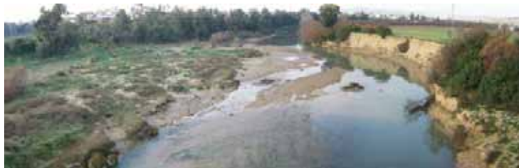
テストゥール周辺の河岸崩壊と河道内堆砂
