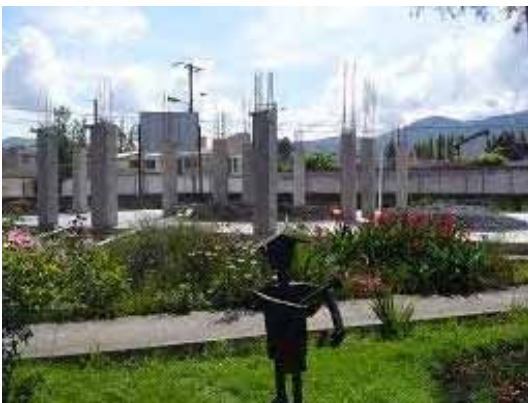
社会的弱者向け基礎技能訓練コース実施のための建設中の校舎（CMI、イバラ）
