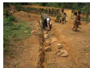
粗石を利用した水路内流水減勢工
