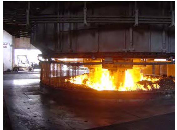
Elbasanフェロクロム製錬プラントの電気炉
