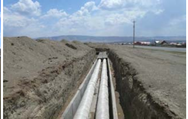
幹線道路沿いはインフラ整備が進められている(写真は暖房配管)。
