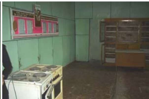
家庭科室。壁塗材の崩落を防ぐためにベニヤ板で覆っている。
