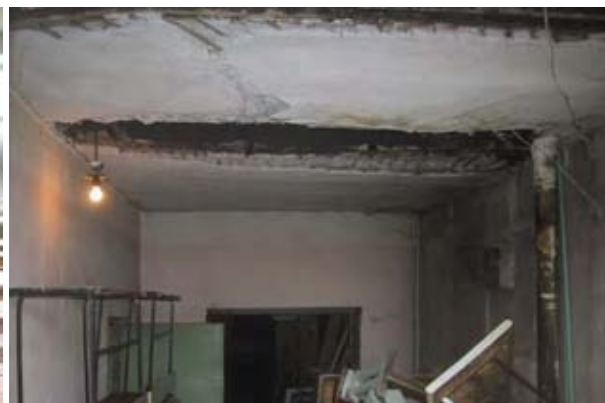
既存北校舎。1階床が崩落し、2008年度以降は使用禁止となる。
