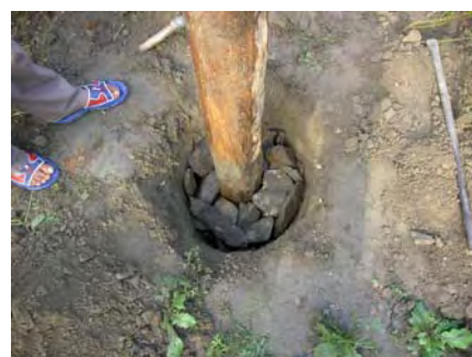
雨量計設置状況 2
