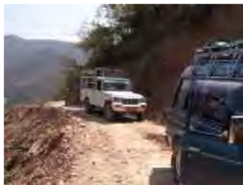
写真 2-11 斜面を切っただけののり面と路面が無処理なトラック道路の状況。雨季の通行は困難となっている。
