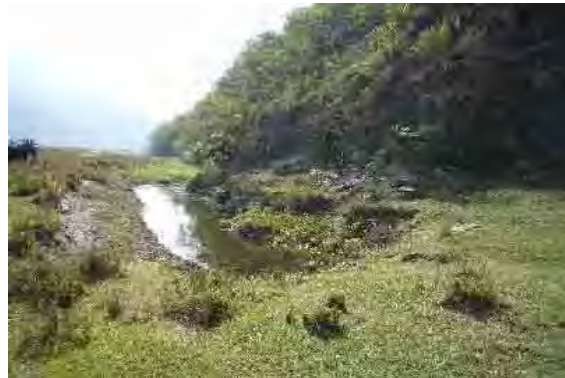
写真 3-1 CH27000 の洗掘状況 (約 3m)
