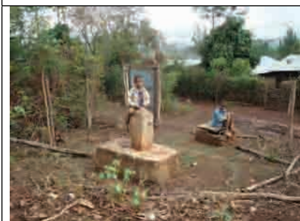
写真-9 既存施設（公共水栓） 既存給水施設のうち、水圧が低いため使用されず放置された公共水栓。
