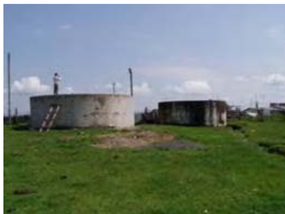
写真-8 既存オフィス配水池:本プロジェクトで増設する。
