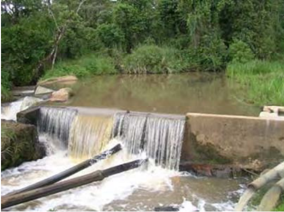
写真-1 既存取水堰:堰下部からの漏水が顕著であり、渇水期には十分な水量が取水できない。
