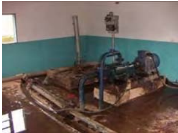
写真-6 送水ポンプ設備:1台故障撤去中、1台稼働中であり、老朽化が著しい為、所定の水量を安定送水できない。
