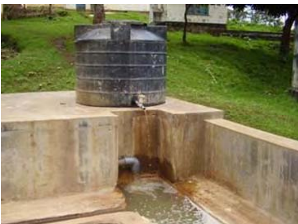
写真-4 硫酸バンド注入装置:注入量のコントロールが出来ない為、凝集効率が低下し、適正な水処理が成されない。
