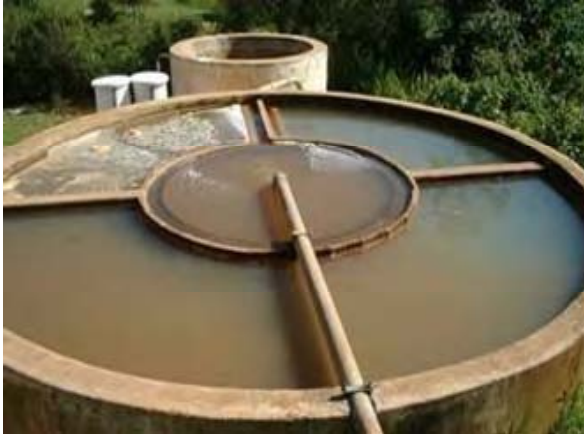
写真-5 沈殿池:流出部でフロックの巻上げが発生している為、沈澱効果をより低下させている。
