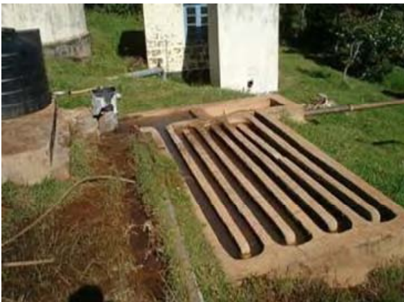
写真-3 フロック形成池:滞留時間が短く、十分なフロック形成が出来ない為、沈澱プロセスでの効率が低下し、適正な水処理が成されない。
