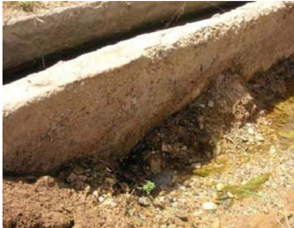
ヌエイマ湧水導水路漏水
