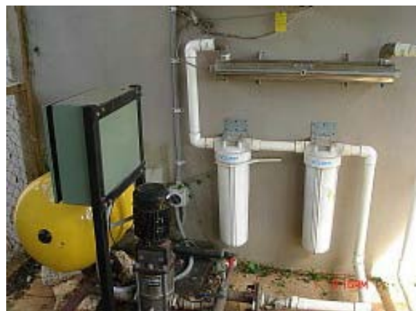
A に設置されている雨水浄化用フィルターと紫外線滅菌装置。次回の施設改善計画の後にはキッチンに利用される予定。A でも他の施設には設置されていない。
