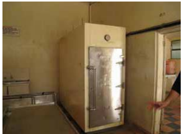
霊安室 死体冷蔵庫 故障中
