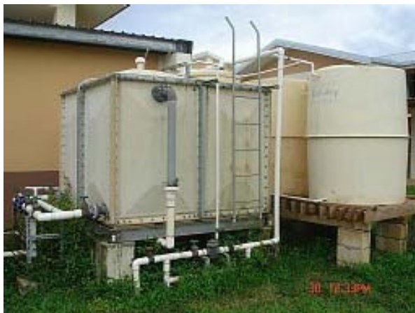
B1 で設置された市水受水槽と容量不足を補うためにトンガ側で増設した受水槽(右側円筒形 2基)
