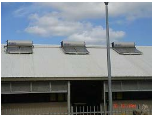
太陽熱温水器が設置されていて患者用のシャワールームで使用されている。雨水を利用している。(B1 では電気温水器が使用されている)
