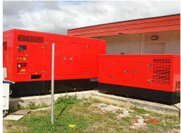
B1 で設置された非常用発電機(右側)とトンガ国側で新設した非常用発電機 (左側、B1 以外のすべてを賄える)
