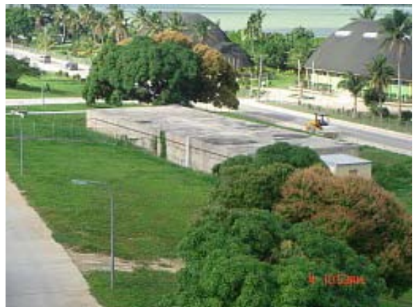
従来からある雨水槽で約 27,000 t の容量がある。(1/3 は消防用として用意してあるが、一般消費用が不足した場合には消防用も利用してしまっている)
