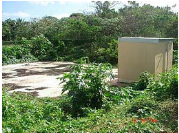
B 1 で新設された排水処理設備で、現状のマスタープランの範囲では将来計画の中では十分な能力を持つ。
