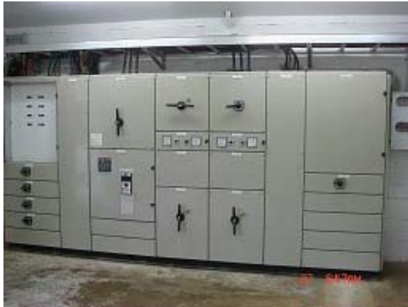
B1/B2 建設時にトンガ側負担で新設された受電・分電盤（スペース的には将来のための増設する余裕がある）
