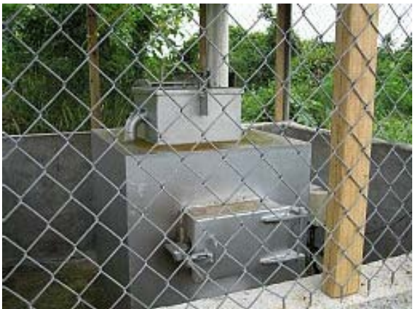
日本のロータリークラブから供与された医療廃棄物処理設備（一度に約5～6Lの要領のものを処理できる）木材の燃焼ガスを利用して滅菌する。
