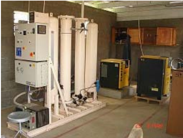
B 1 で新設された医療用酸素発生設備、及びポンベ充填設備（調査時点で充填用コンプレッサーが故障し、使用できなくなった、ニュージーランドの代理店と交渉中
