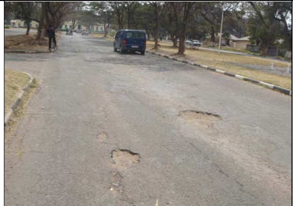
N2：カウンダ道路 多数のポットホール有り
