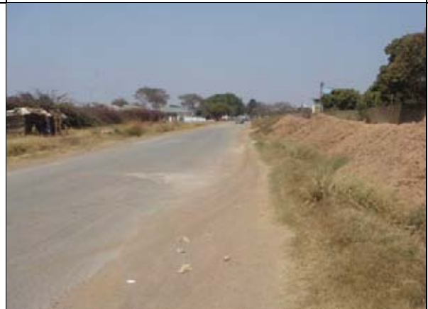
N5：サンビア道路 排水施設が未整備
