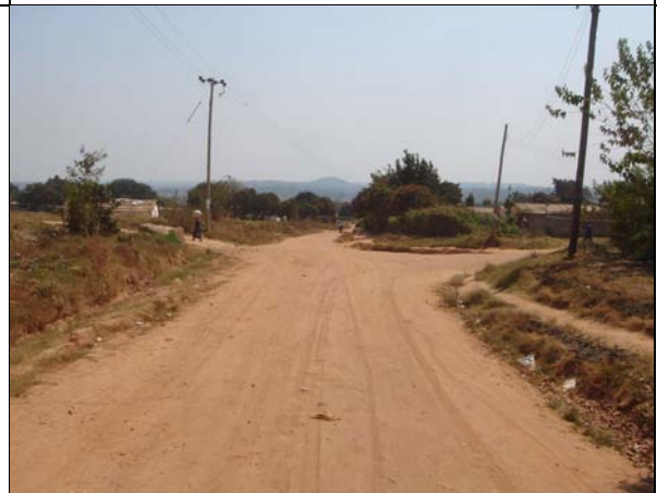
N8：チャンベシ道路 舗装・排水設備が未整備
