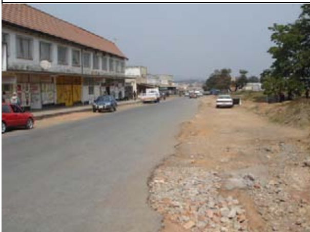
N6：マテロ道路 排水不良による舗装破損
