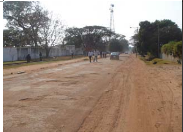
K7: カンタンタ道路 排水不良による舗装破損
