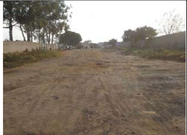
K2: ユークリッド道路 大型車両による道路破壊
