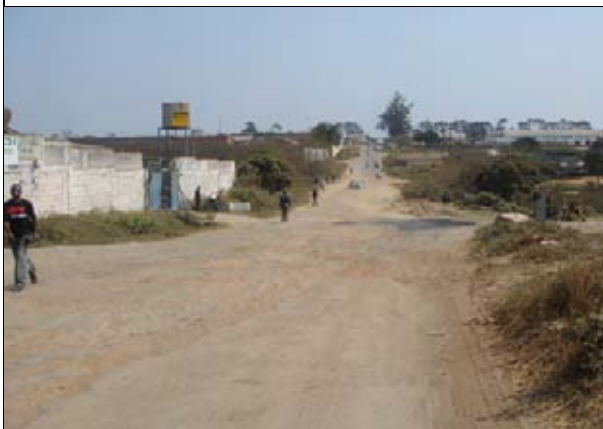
K8: ナトワンダ道路 排水不良による舗装破損
