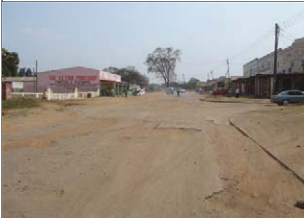
N3：マコリ道路 破損がひどく走行性がかなり悪い
