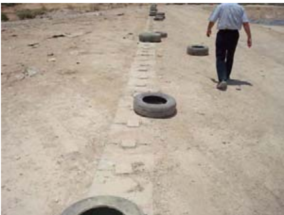
し尿を流す管渠
