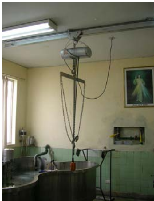
水治療室（旧式のハバードタンクであると共に、患者の搬送に手動クレーンを使用しており、危険で効率が悪い）
