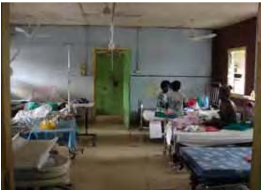
写真-3：病室 床や建具などが老朽化している。
