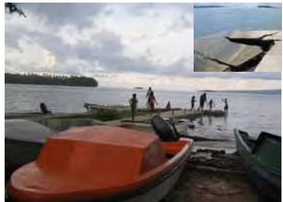
写真-6：病院専用栈橋 救急搬送用のボートが着く栈橋は、地震で亀裂が入り陥没している。草の根無償資金協力にて修復予定。
