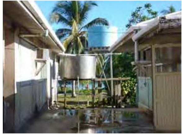
写真-14：ヘレナ・ゴールドディ病院(ムンダ村) 高架水槽と雨水貯留タンク： 豊富な雨量で市水の不足をカバーする。 医療施設では一般的。
