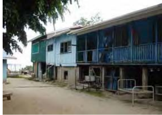
写真-2：増築による床の段差 増築時に異なる床レベルで施工しており、医療活動や障害のある患者に不便な段差を生じている。
