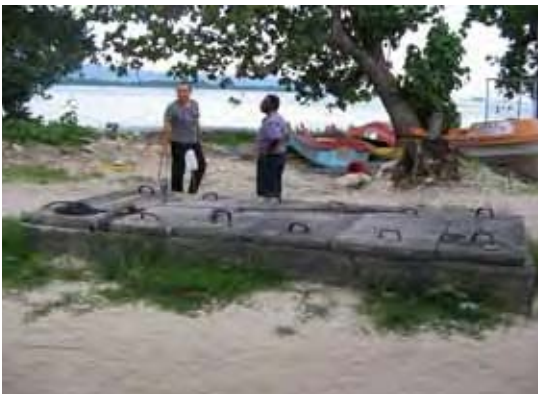
写真-5：排水槽 地域の排水も処理しているが、海へ放流するためのポンプが1台のみで、故障時のバックアップが必要。
