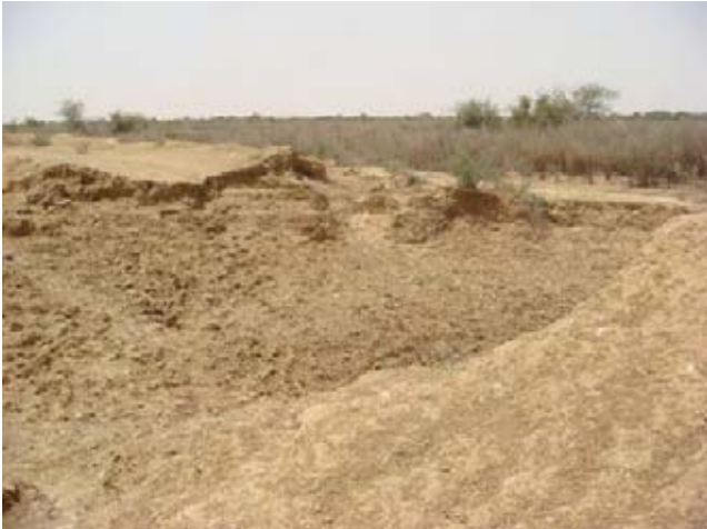
写真7 三次水路 (ダメージが大きい)
