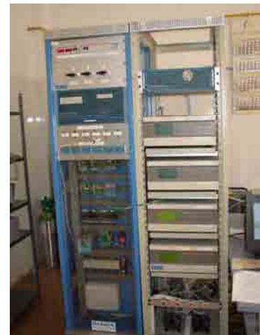
図 3.3-8 自動測定機ラック
