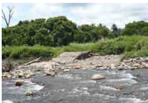
写真 2-3 Rotaovei（崩壊したカルバート）
