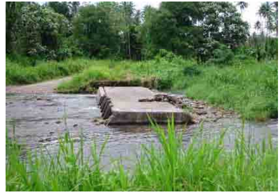
13. Warakapes 橋 破損したコンクリート構造物が河床に残る。
