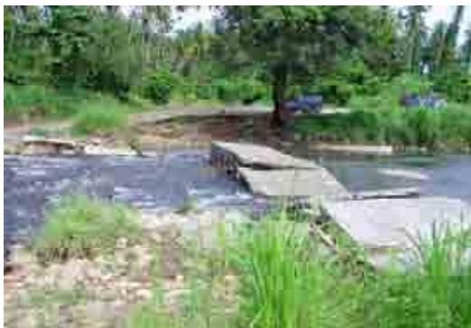
15. Rawa-1 橋 旧渡河構造物が河床に残っている
