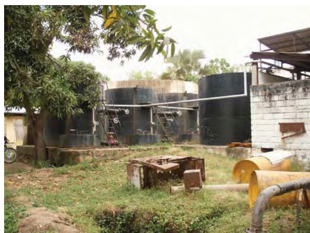
15. ジュバ市内既存浄水場のろ過装置
