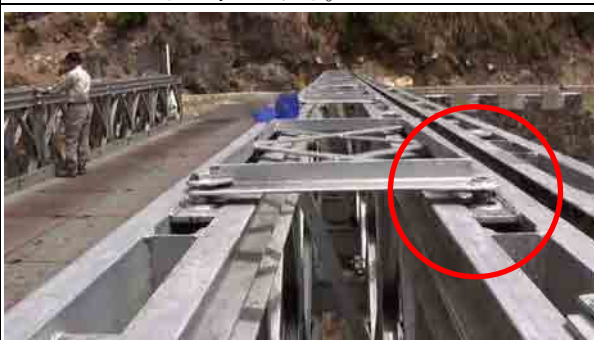
写真 4：バスチュ橋 主構連結部分(ボルト)の浮き上がりが生じていることから、橋梁自体にたわみが生じ、連結部分が浮き上がっていると考えられる。
