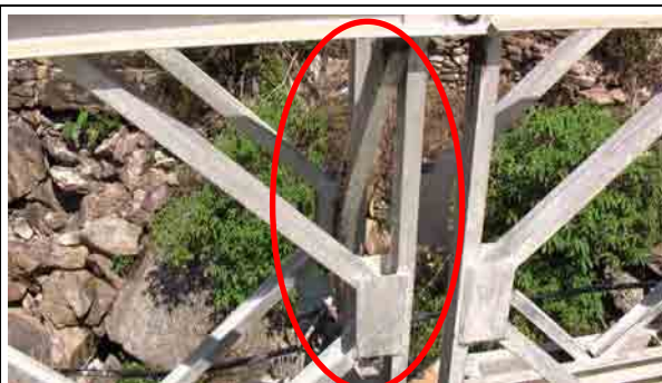
写真 2：ラワカー橋 鉛直材に座掘が生じていることから、橋梁自体のたわみにより一部の鉛直部材に負荷がかかっていると考えられる。
