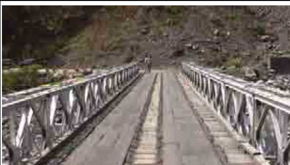
写真 6：ニャラチュ橋 床板が木製で大型車の通行に支障が生じている。対象橋梁 6 橋の幅員は、ほぼ同じであるので、橋梁上では車両のすれ違いができない。
