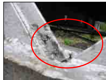
図 2-12 既設橋梁の損傷(腐蝕)
