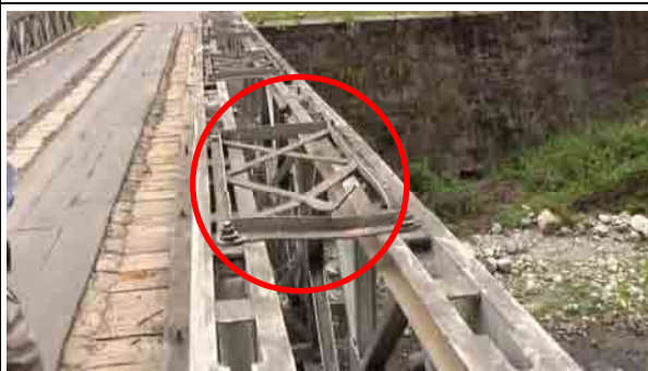
写真 8：ブリチュ橋 床板が木製で破損があり、フレームに歪みが生じている。また、沿道斜面からの落石による損傷も見られている。
