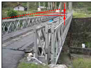
図 2-11 既設橋梁の損傷(たわみ)
