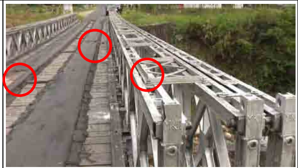
写真 10：チャンチー橋 床版が木製で破損があり、フレームに歪みが生じている。床版が木製のため、大型車は通過する際に速度を落として走行しなければならない、ボトルネックとなっている。
