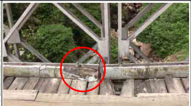
写真 12：ローリン橋 床版が木製で破損があり、フレームにも錆や破損が生じている。損傷の原因は老朽化の他に、沿道斜面からの落石が橋梁を直撃した時に生じる破損も見られた。
