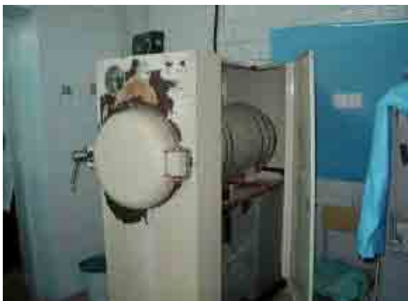
センター I 手術室横の滅菌室にあるオートクレーブ。錆が多く、危険な状態。
