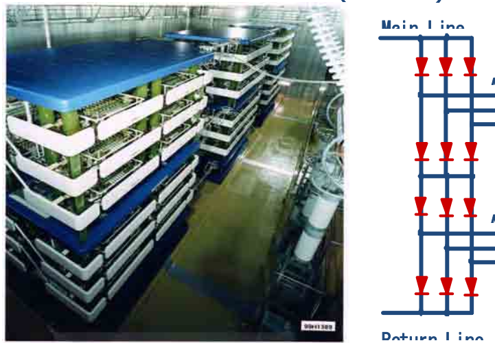
図 5.2-13 紀北変換所に採用されたコンパクト交直変換器(重要装置)
