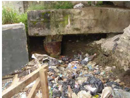
Nou 橋 右岸橋台の杭頭破壊
