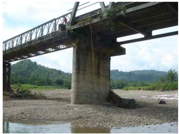
Idano Gawo 橋 上流側へ傾斜した橋脚
