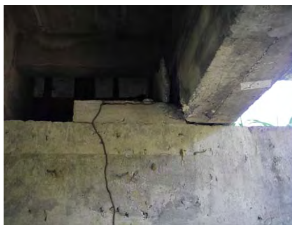
Gido Si'ite 橋 RC 桁が支承台座から落橋
