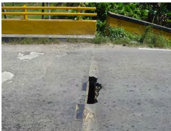
Gido Si'ite 橋 橋台陥没による路面のギャップ
