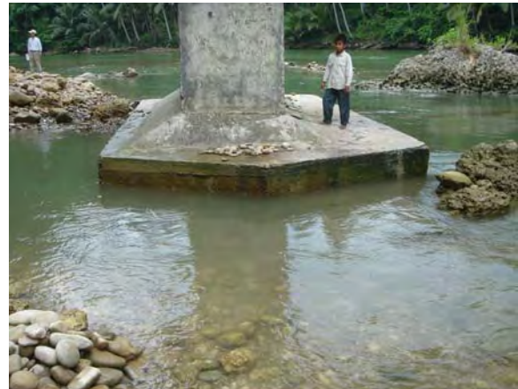
Mezaya 橋 基礎が洗掘された橋脚
