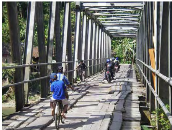
Mezaya 橋 走行障害の木製床板
