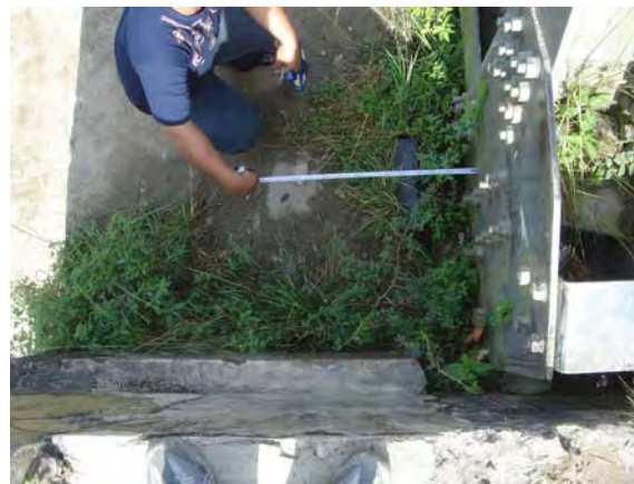
Nou A 橋 トラスが約 60cm 下流側へ移動
