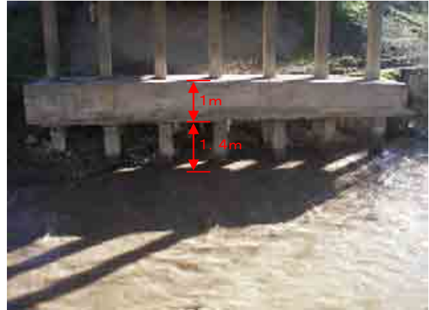
橋脚(右岸) 基礎杭が洗掘により露出
