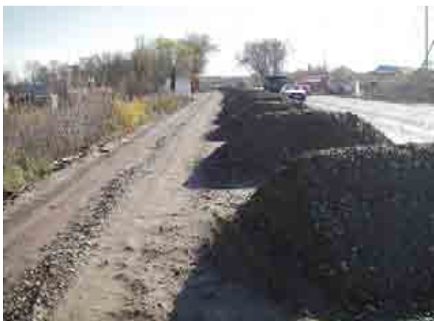
橋梁付近道路の路盤改良工事 MOTC(運輸通信省)により実施 2007年7月完了予定
