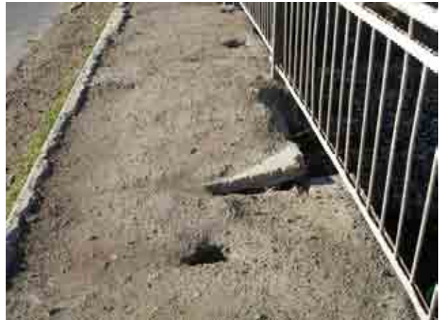
歩道部 PC板の欠落により穴が開いている
