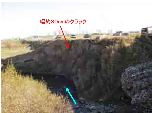
下流右岸状況 崖が洗掘を受けている
