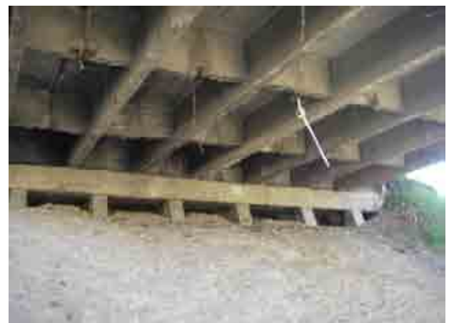
橋台(右岸) 盛土の圧縮沈下により杭が露出している
