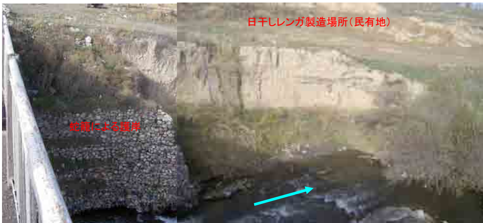
下流左岸状況 崖が洗掘を受けている(崖部が水衝部となっている)
