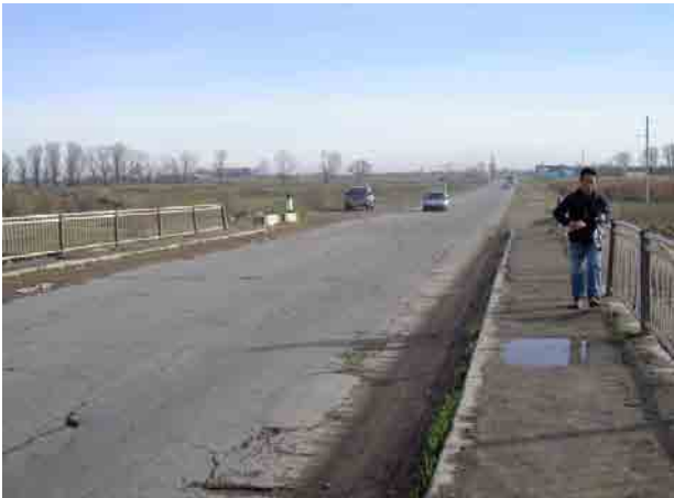
橋面状況 網目状クラックが多数ある
