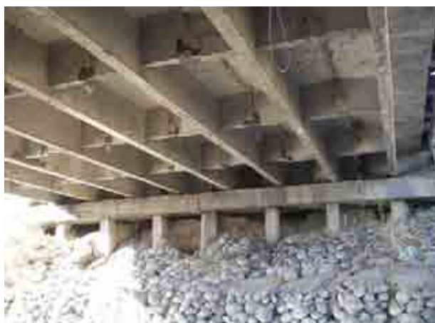
桁及び橋台(左岸) アラメジン橋(橋梁番号No.1)と同様の構造
