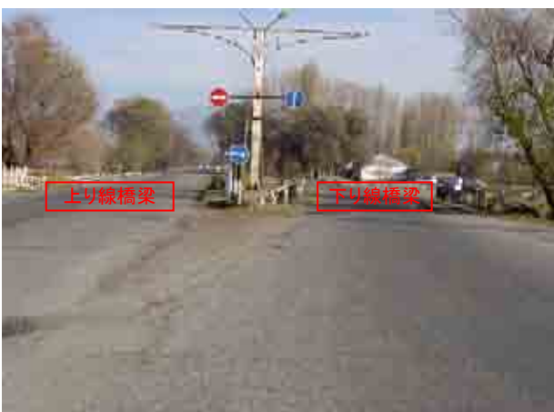
下り線と上り線橋梁の分岐部(トルガルト方面を望む) センターライン等の路面表示がない
