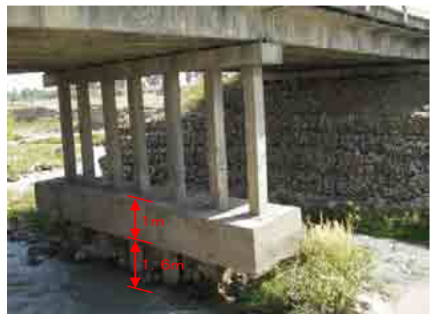
橋脚 基礎杭が洗掘によって露出している
