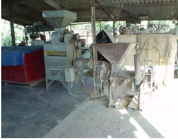
ジャグハイ郡の乾燥・精米機 (乾燥機、籾摺り機は開発調査で実証試験のため導入され引き続き利用されている)
