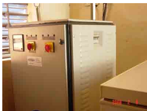
自動定電圧装置
