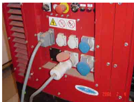
発動発電機。正常に稼働している。
