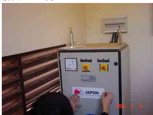
自動定電圧装置。発動発電機と同じ部屋に 配備されている。正常に稼働している。
