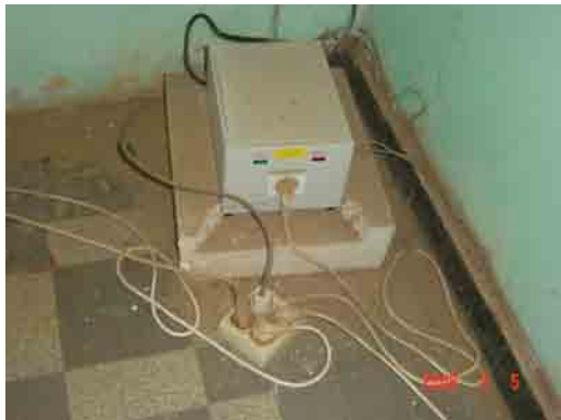
1 台の自動定電圧装置から 4 台の冷凍、冷蔵庫に配電している。
