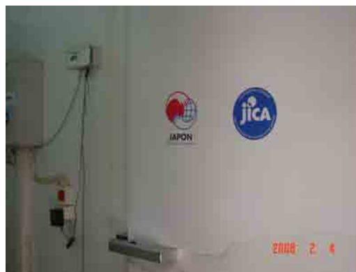
ワクチン貯蔵庫内コールドルーム（冷凍 庫）
