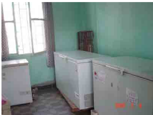
冷凍、冷蔵庫。手前側が日本からの供与品
