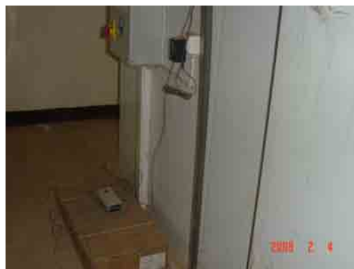
温度アラームが未設置。ケーブルが乱雑 に置かれている。
