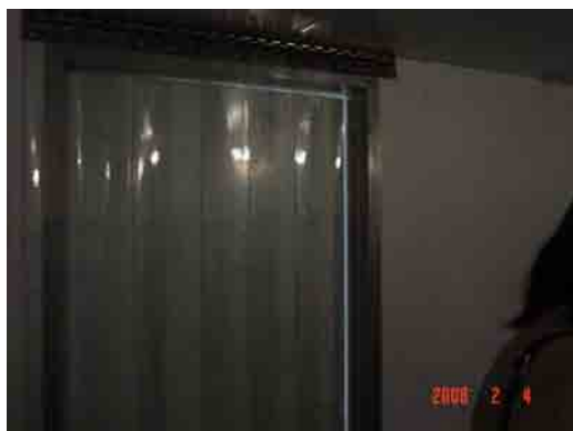
コールドルーム（冷凍庫）入口。ビニ ルカーテンで外気を遮断
