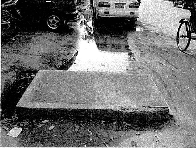
電話ケーブルボックス(車線内構造物) (天端高が上がって道路障害物となっている)
