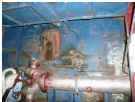
消防車の水槽は腐食による亀裂を溶接で応急補修
