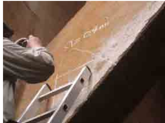
Photo 2.2.2-3 Etude avec échelle à fissures
