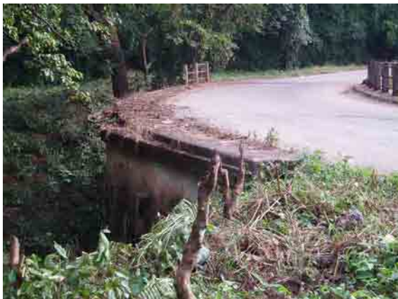
⑤橋梁構造の損傷-3 事故による高欄の欠落
