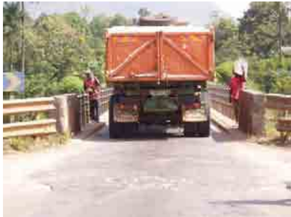
④橋梁通過車両 大型車通過時の歩行者通過が困難
