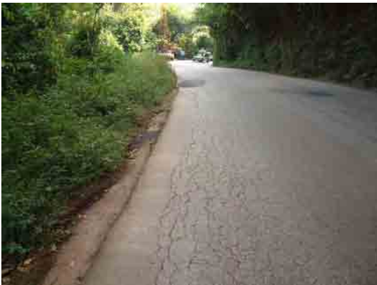
③コナクリ側アプローチ道路の舗装の損傷-1 盛土の変状（すべり）に起因する
