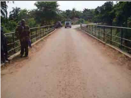
③路面状況 一車線橋として利用、舗装は劣化している
