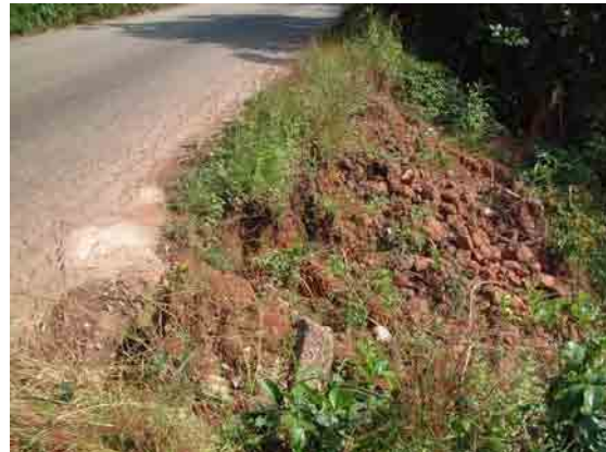
④コナクリ側アプローチ道路の舗装の損傷-2 道路のり面の崩壊
