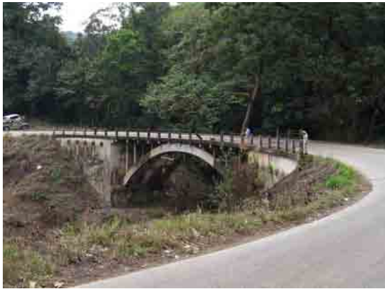
①橋梁全景（下流側左岸より撮影） 橋梁はコンクリートアーチ曲線橋（R=45m）
