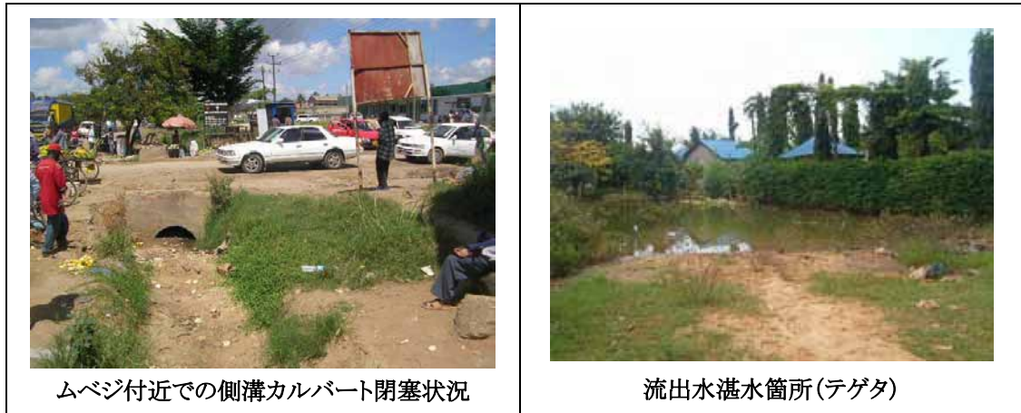
図 A3 ニューバガモヨ道路排水施設および排水不良状況
