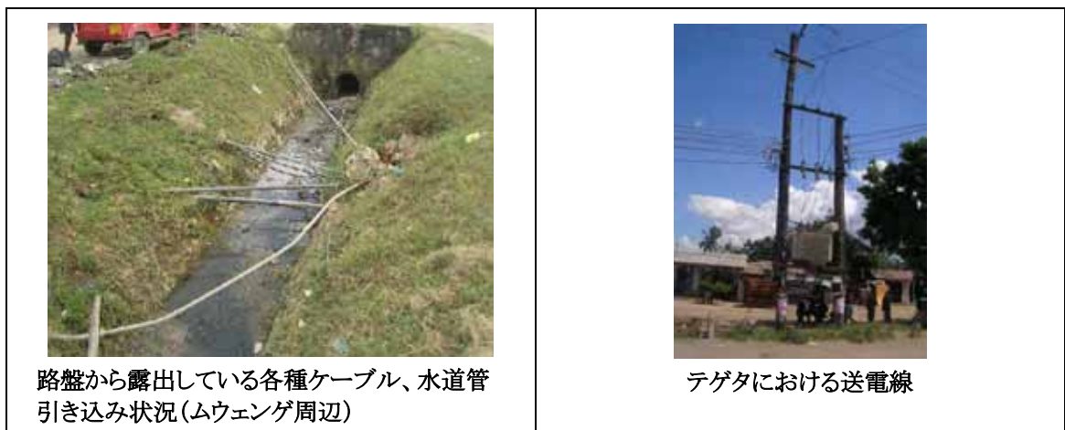
図 A7 ニューバガモヨ道路における道路附帯・埋設構造物
