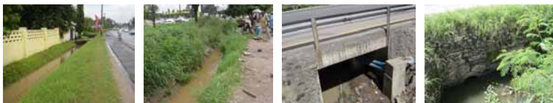
図 5.4.1 ニューバガモヨ道路排水施設
