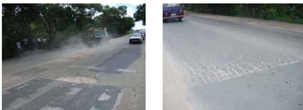
図 5.1.2 ムウエンゲ～アフリカーナ～テゲタ間の路面状態
