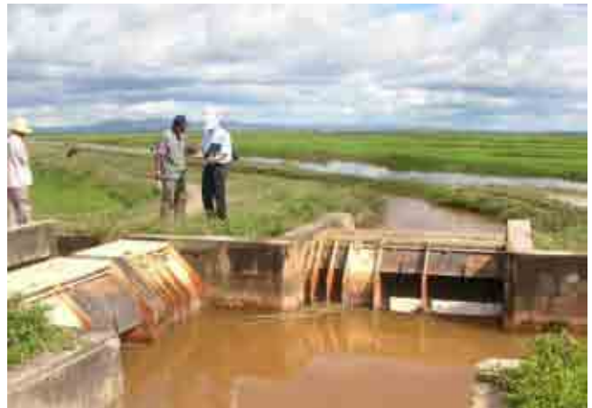
幹線用水路 (P5) の末端に設置されている 分水ゲート (ディストリビュータ) 部品の欠損や錆も認められるが、作動している
