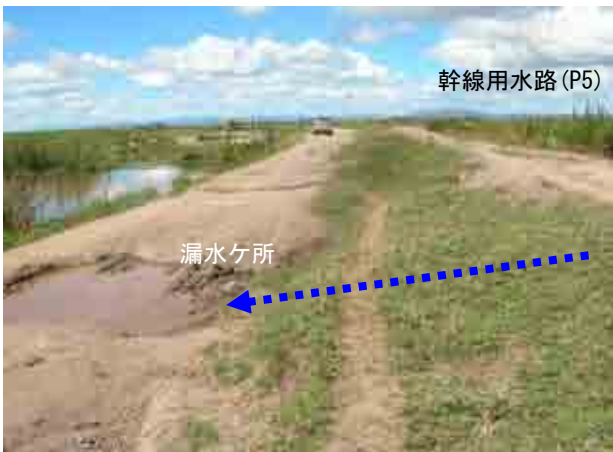
幹線用水路 (P5) の堤体 左岸堤防からの漏水
