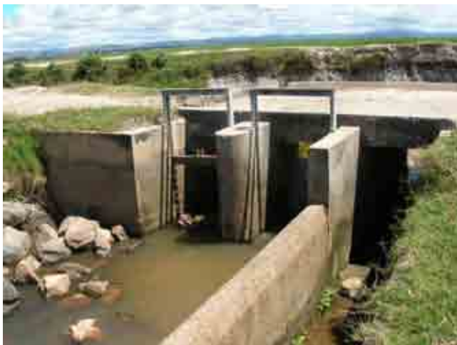
2次排水路から1次排水路（D2）への流出部 （排水再利用施設）ゲートが欠損している
