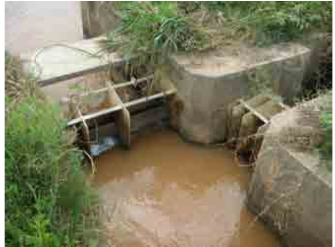
2次用水路の始点に設置されている 分水ゲート（ディストリビュータ） 開度設定による流量制御はなされていない
