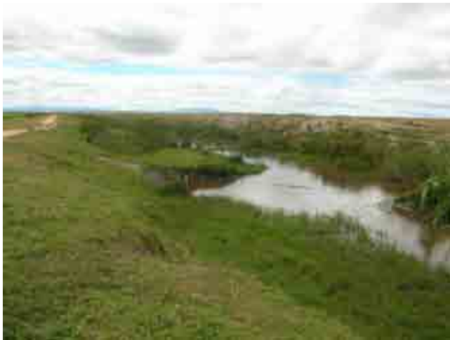
1次排水路（D0） 法面の崩壊や植物の繁茂により、通水断面が阻害 されている
