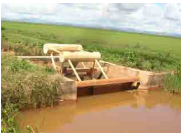
幹線用水路 (P5) に設置されている 上流水位調整ゲート (アミルゲート) 部品の欠損や錆も認められるが、作動している
