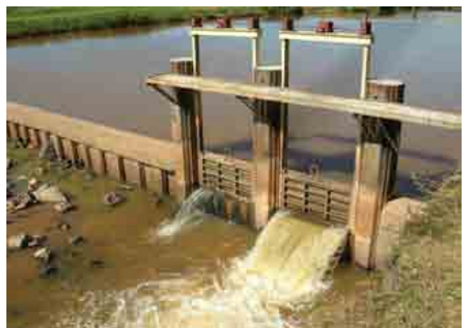
サハベ頭首工の土砂吐ゲート 操作不能状態になっている
