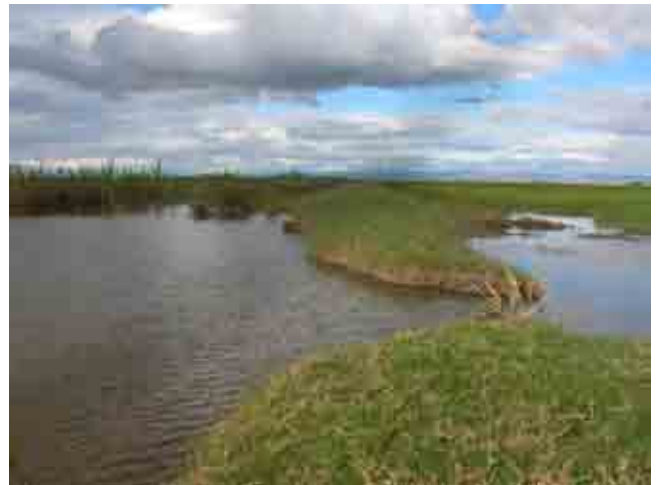
1次排水路（D1）右岸堤防 堤防が完全に決壊し、走行不能になっている
