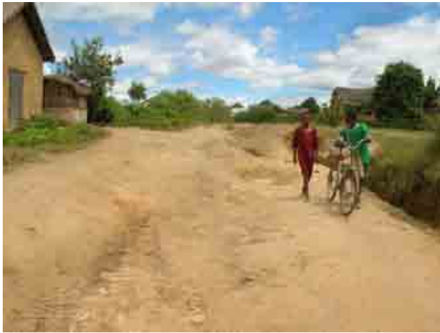
農道 (R1) 路面の不陸が著しい
