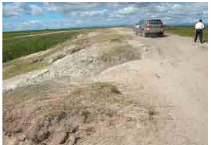
洪水防御堤 法面の崩壊ヶ所
