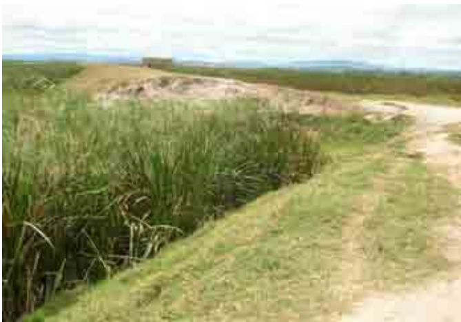
洪水防御堤 破堤したヶ所が仮復旧されている
