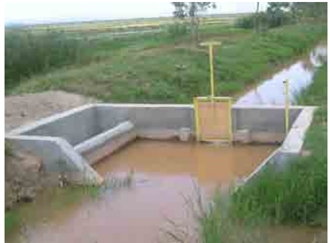
2次排水路における排水再利用施設 開発調査のパイロットプロジェクトにて設置 （2005年12月撮影）
