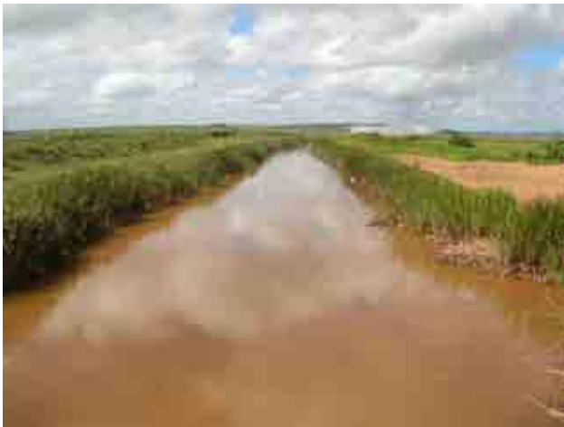
幹線用水路 (P5) の上流部 この区間の堆砂が最も多い
