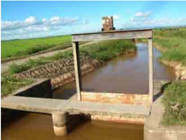
1次用水路に設置されている 水位調整ゲート（スルースゲート） スピンドルが欠損し、操作不能状態
