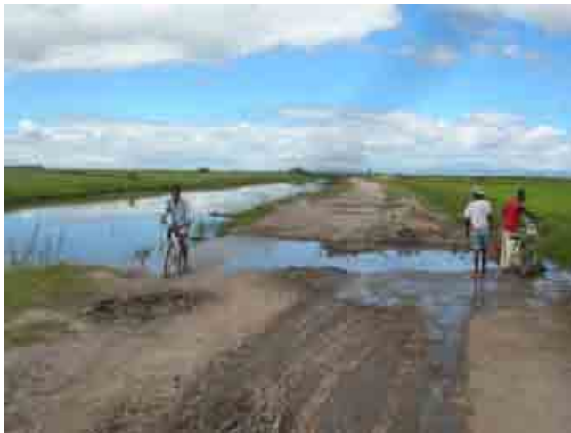
幹線排水路 (D1) 沿いの農道 (R2) 路面の凹部に、水が溜まっている
