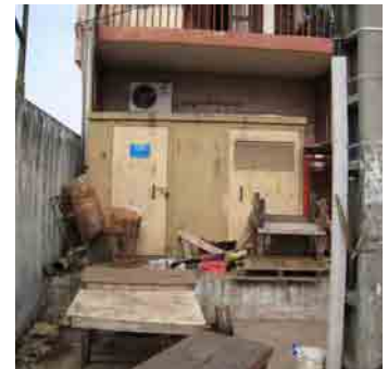
■ オルミ市場の前面に設置されている変電施設。電力引込みはここからとなる。
