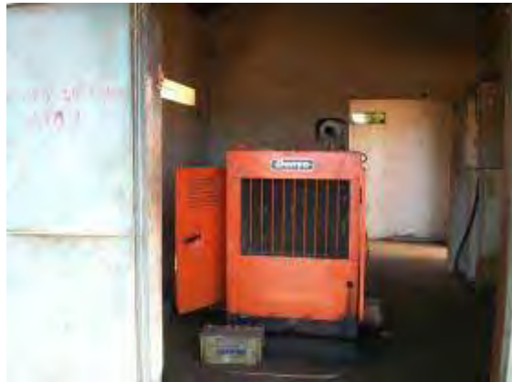
Andranahinaly Fukutan (パートナーサイト) メカニシャンが2人交代で管理している。技術力は日常点検程度であるが、清潔に保たれている。状態は良いが発電機償却期間が過ぎており、エンジン、ダイナモの老朽化が著しい。
