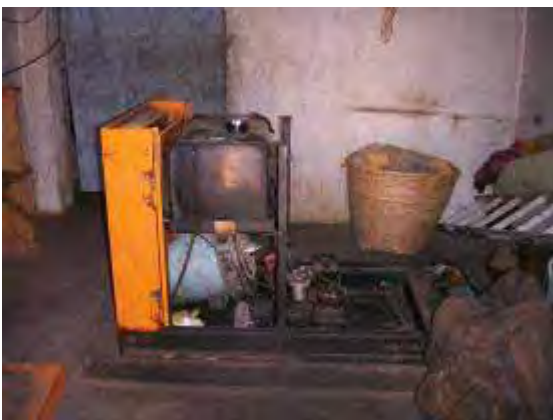
Shakaraha 2 各戸給水 2002 年に修理パーツの購入方法がなく発電機の修繕ができず、JIRAMAの公共電力に切り替える。
