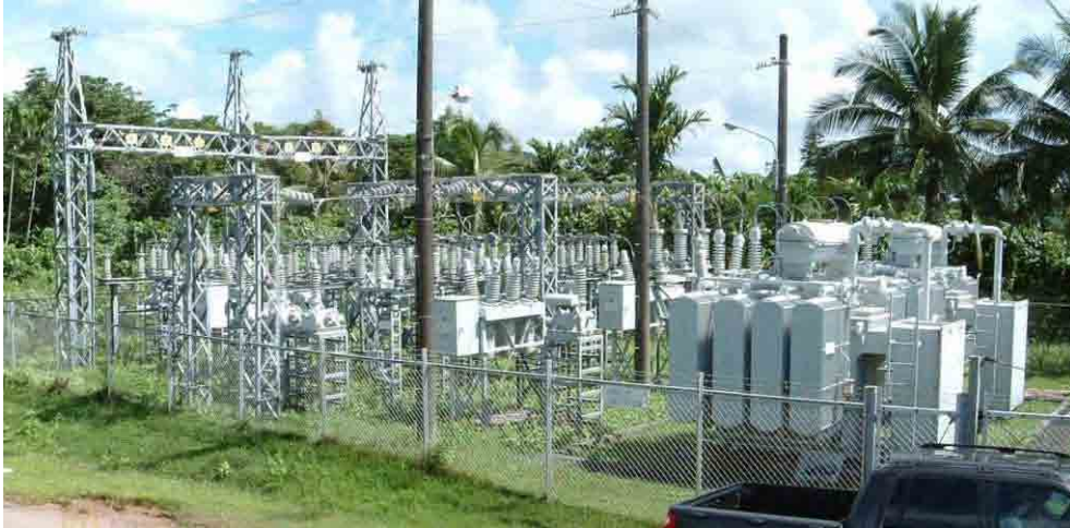
Fig. 2.4.2-6 Aimeliik Power Substation
