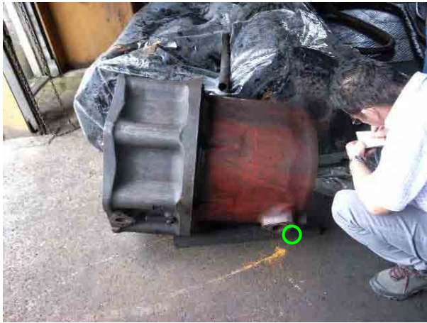
冷却水ジャケット（緑丸部内面に亀裂）
