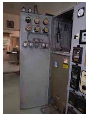
スイッチギアの内部状況
