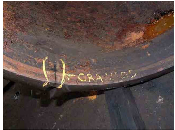
冷却水ジャケットに生じた亀裂
