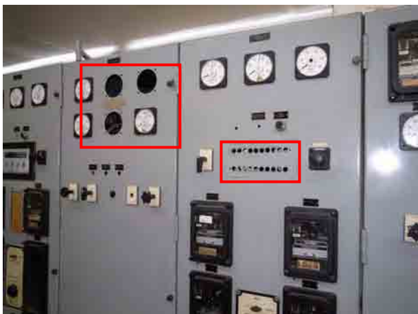
欠損した計器
