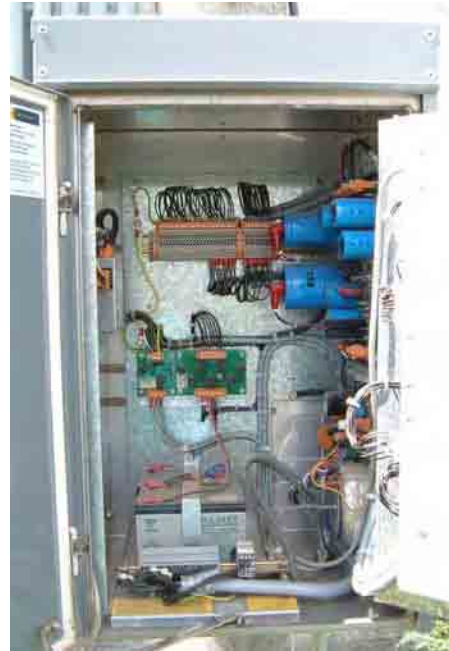
図 2.4.2-11 コクサイ変電所（リクローザ制御箱）
