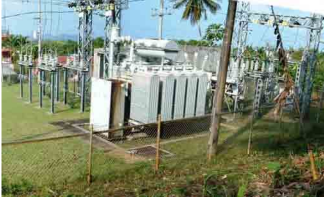
図 2.4.2-8 アイライ変電所（全景）
