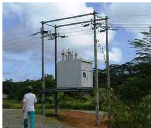
図 2.4.2-2 アサヒ変電所（送電線遮断器）
