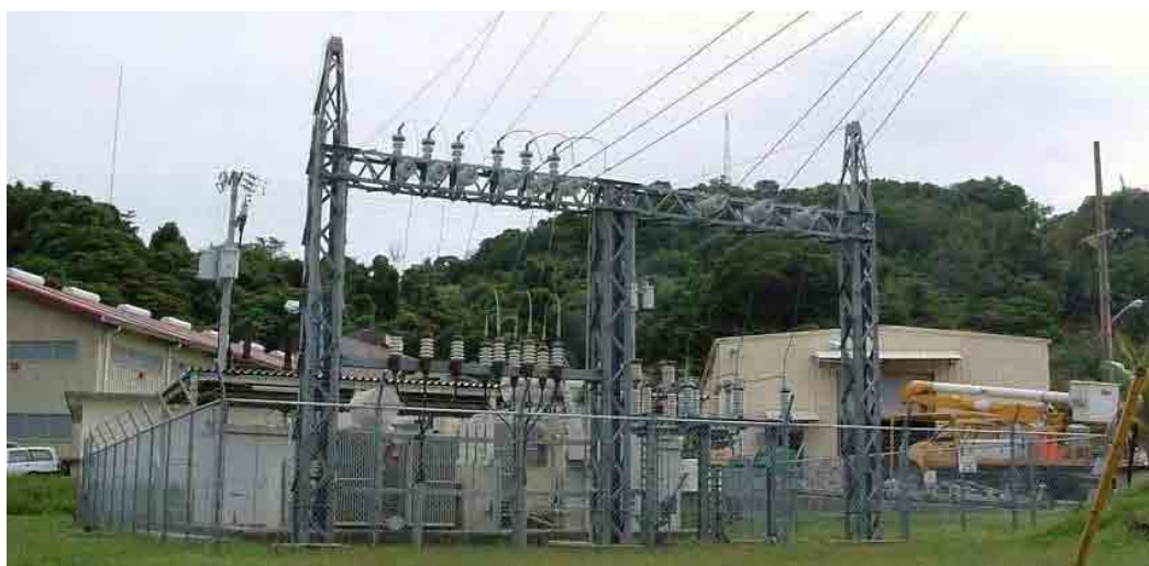
図 2.4.2-7 マラカル発電所（変電所ヤード）
