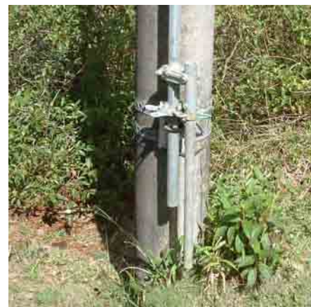
図 2.4.2-15 負荷開閉器操作装置（施錠なし）
