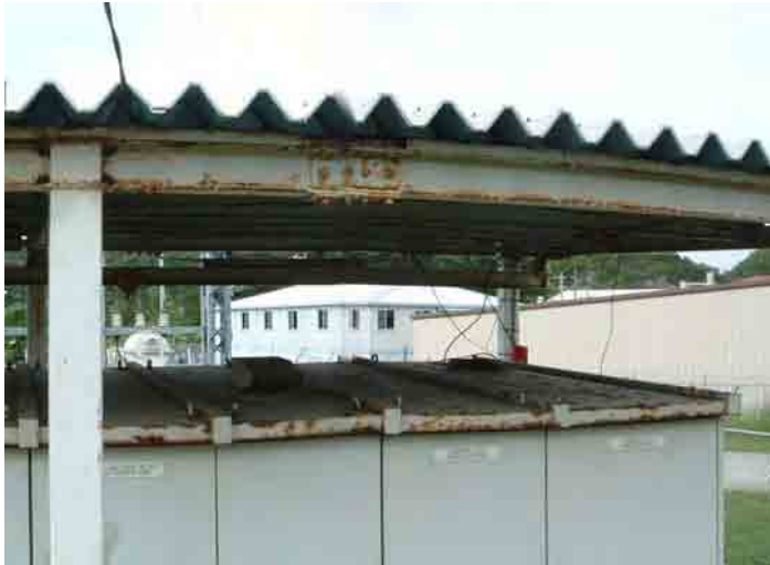
図 2.4.2-16 屋外スイッチギア天井部
