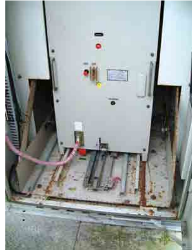
図 2.4.2-17 屋外スイッチギア内部
