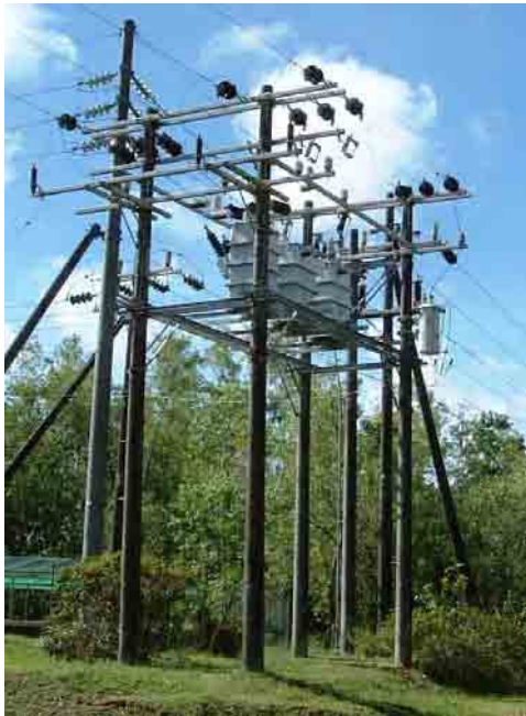
図 2.4.2-10 ネットケン変電所（全景）
