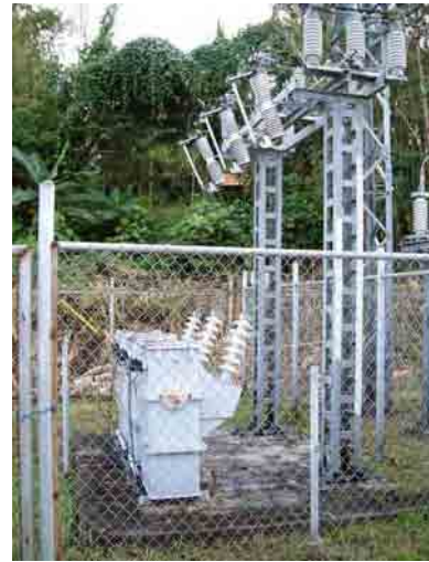
図 2.4.2-13 アイライ変電所（所内変圧器）
