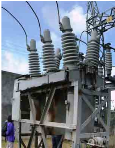
図 2.4.2-12 アイライ変電所（油入遮断器）
