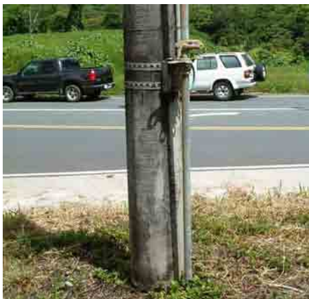
図 2.4.2-14 負荷開閉器操作装置（表示なし）
