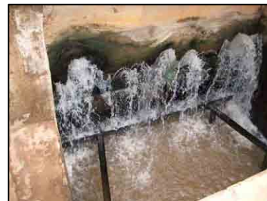
アンドンスラ取水ゲートからの漏水
