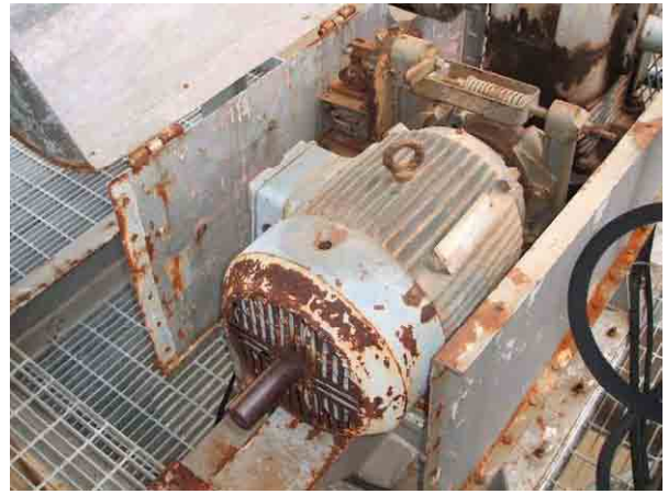
ローレンチェリ頭首工ゲート巻上げ機 (老朽化が進んだゲート可動用のモーター)
