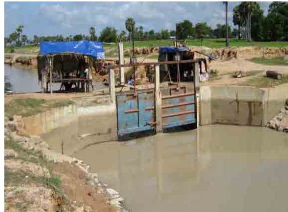
南幹線水路上の灌漑施設(チェックゲート) (老朽化および損傷が激しい灌漑施設)
