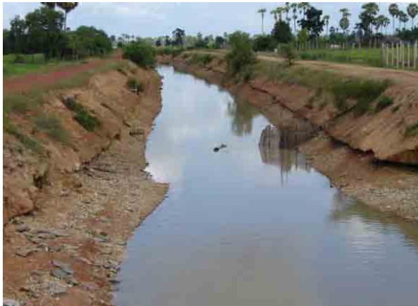
南幹線水路 (法面浸食の顕著な南幹線水路)
