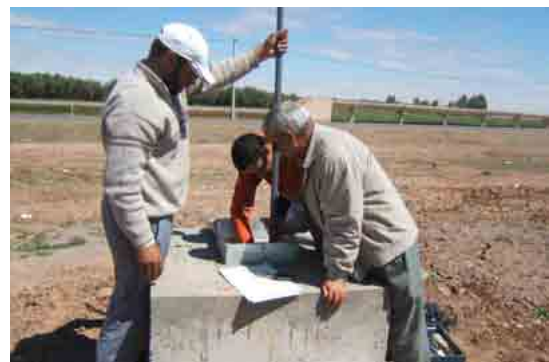
Installation d'un hydrographe
