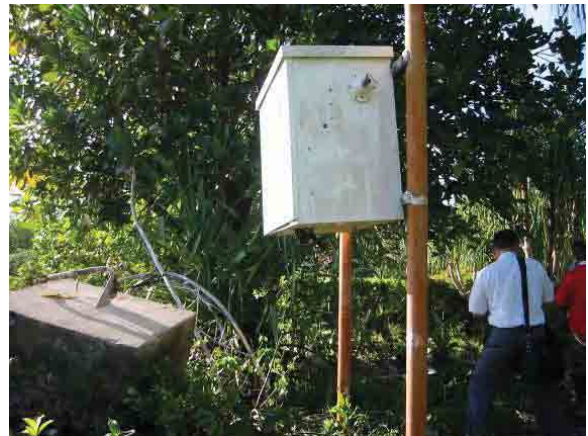
アンテナ支線基部と整合器ボックス
