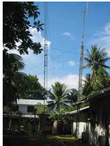
FM 送信用アンテナ(TMD の敷地内)
