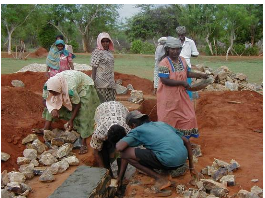
CMR による多目的ホールの基礎工事 (ガネッシャプラム村)
