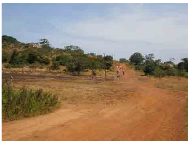
本計画地前の道路状況。写真奥がマム一市内方向であるが、約2.5km区間が同様の状況であり、本計画施設、工科大学、及び沿線住民の通学・生活道路でもあるため、改良・修繕は急務である。
