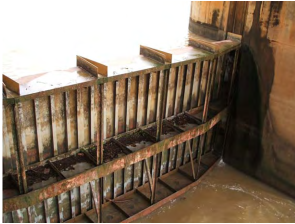
写真-7. 頭首工ゲート扉体(下流側)の近景(常時)。扉体自体では、塗装の劣化に伴う錆の発生、水密ゴム劣化による水密性の低下が見られる。
