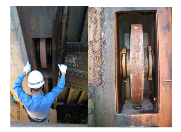
写真-10. 同ローラー部の近景・調査状況(ゲート開門調査時撮影)。ローラーが回転しない理由は、ローラー軸と軸受け(ローラー内側)が発錆により癒着したためであることが判明した。このため、軸・軸受けの交換が必要となる。
