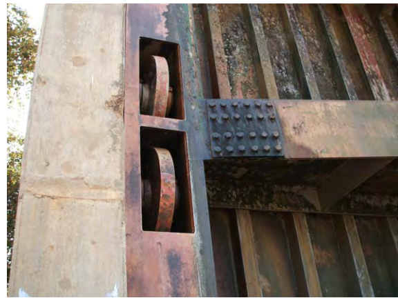
写真-9. 頭首工ゲート扉体とローラー部の近景(ゲート開門調査時撮影)。ゲート1門当り8組(左右に各4組)のローラーが、5門全てにおいて回転しないため、洪水時のゲート開操作において開閉装置(電動巻上げ機)が過負荷となり、開門に不具合を生じる。
