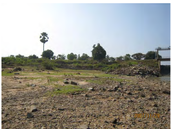
写真-11. 下流側より見た頭首工下流右岸護岸状況(ゲート開門調査時直後に撮影)。1974年の工事で発生した岩石片を乱雑に敷き並べているが、洪水放流時の流況に対し不適切であり、護岸の侵食が進行している。
