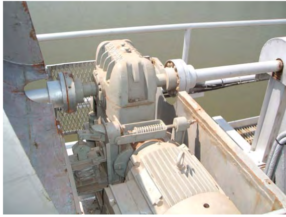
写真-13. ローレンチェリー頭首工ゲートの開閉装置（電動巻上げ機）の近景。建設後33年経過に伴う老朽化と、ローラーが回転しないためにモーターへの過負荷により劣化が進み、操作の不具合が5門のゲート全てにおいて見られる。
