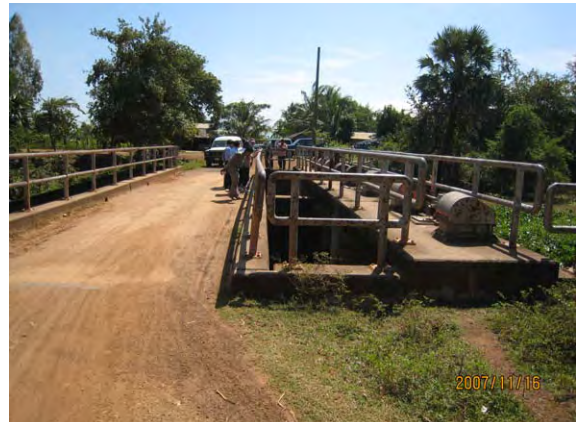
写真-18. アンドンスラ取水工左岸取付部から見た管理橋及び同取水工ゲート開閉装置（手動による巻上げ機）の近景。老朽化に伴う開閉操作の不具合が生じている。なお、管理橋は劣化が軽微であるため、改修工事を行わない。
