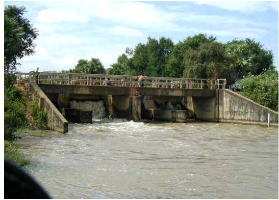
写真-14. 下流側より見たアンドンスラ取水工全景（常時）。建設後33年経過しゲート老朽化に伴う水密性が低下している。灌漑時には、取水工下流側・北幹線水路内への流量調整機能が確保できない。また、洪水時には、北幹線水路への洪水流入防止機能が不十分となり、下流地区における湛水・溢水被害が生じている。
