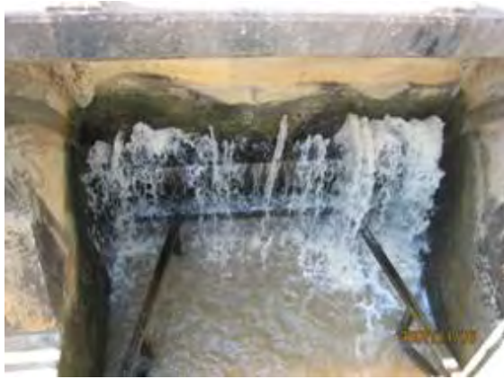
写真-17. 下流側から見たアンドンスラ取水工ラジアルゲート近景（常時）。老朽化に伴い4門のゲートのうち、中央寄りの2門のみ開閉操作が可能であるが、水密性の低下により、常時漏水が発生している状況である。
