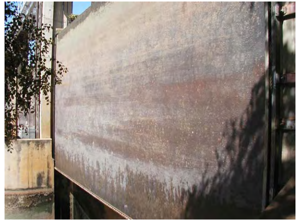
写真-8. 頭首工ゲート扉体の近景(ゲート開門調査時に上流側より撮影)。常時水没していることより、扉体表層の塗装の劣化、錆の発生が見られるものの、扉体鋼材自体の腐食は進行しておらず流用可能な状態である。
