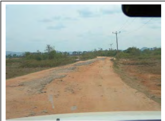
改修が必要な農村道路
