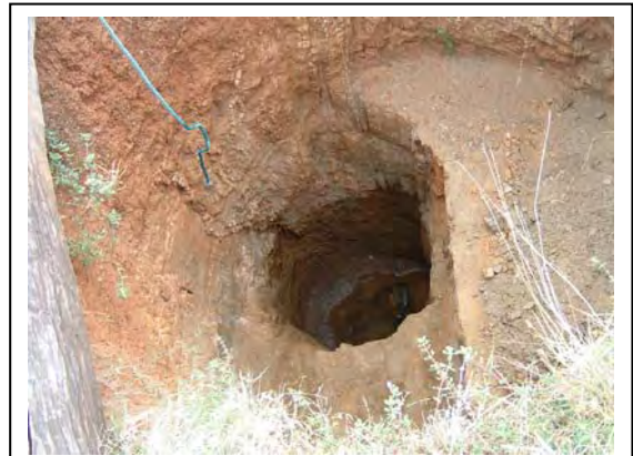
改修が必要な農業用井戸
