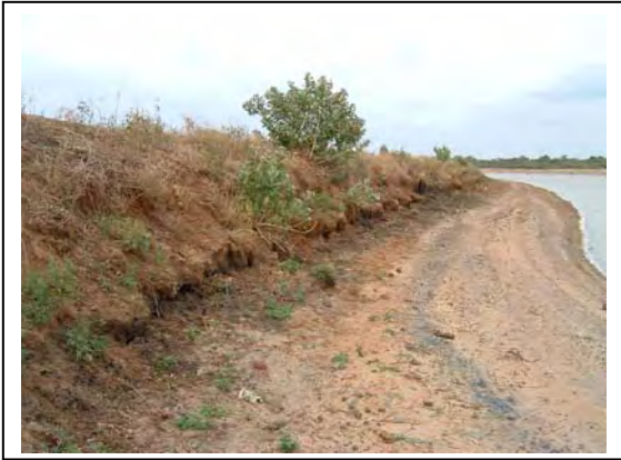
改修が必要なタンクの堤防法面
