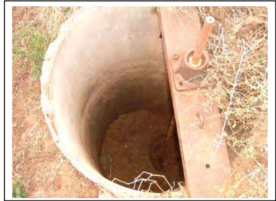
改修が必要な取水ゲート
