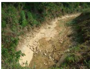
幹線水路上流部 コンクリートライニングはされていない。土砂上げ等を行った形跡は無い。
