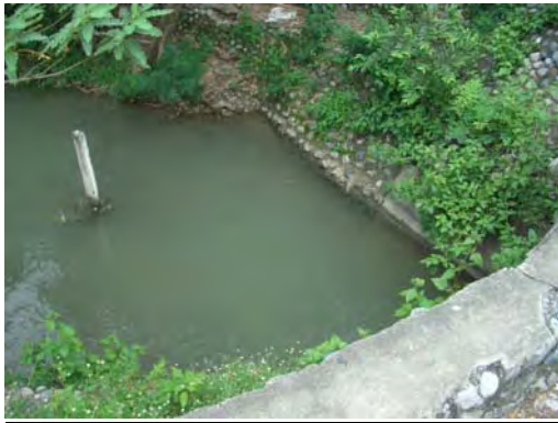
主水路上流 概ねコンクリートもしくは玉石でライニングされており、状態は良い
