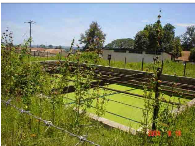
写真3：トロロ県病院の下水システム（汚水槽）。雨季の増水による汚水漏出により周辺住民から苦情が頻発している状況。（9月18日、トロロ県病院）
