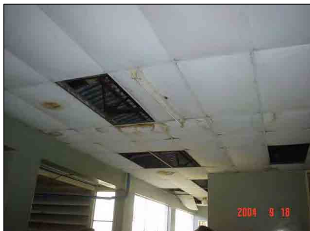
写真4：ブゾルウェ・トロロ県病院（ブゾルウェ総合病院）の天井の様子。漏水が激しく天井を張替える必要あり。（9月18日、ブゾルウェ総合病院）
