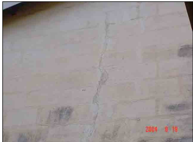
写真8：ブドゥダ総合病院施設の壁面。同病院施設には、いたるところにクラックあり。（9月19日、ブドゥダ総合病院）
