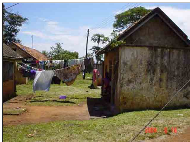
写真2：トロロ県病院の職員宿舎の様子。老朽化が激しい上に衛生状態が劣悪な状況。（9月18日、トロロ県病院）
