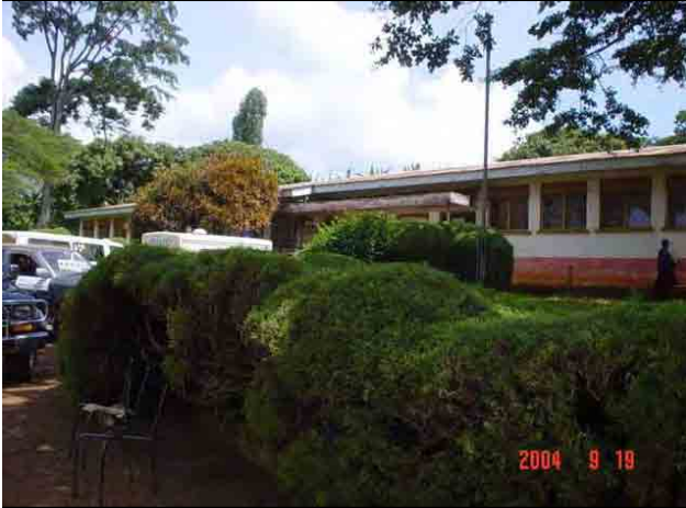
写真7：ブドゥダ・ムバレ県病院（ブドゥダ総合病院）の外来診療室。施設の老朽化が激しく、改修の必要性・妥当性は高。（9月19日、ブドゥダ総合病院）
