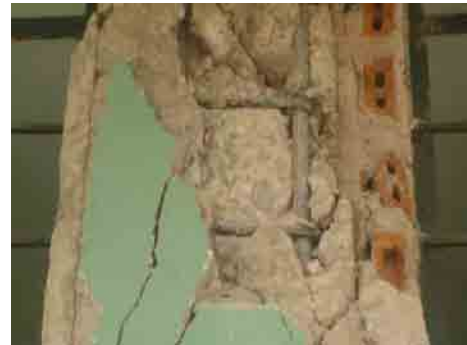
Columna destrozada del 2° piso del pabellón de aulas de la escuela de San Antonio Papua, provincia de Chíncha
