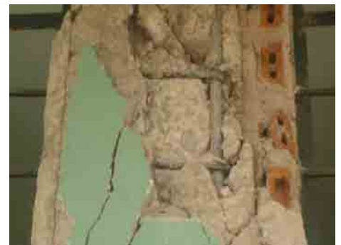
チンチャ郡・サンアントニオパドゥア校の教室棟2階の柱の破壊状態。
